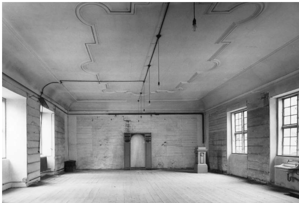
Bogsalen til "Fyens Stiftsbibliothek" i Gymnasiebygningen efter rømningen. Fotografi fra 1966. Odense Bys Museer
